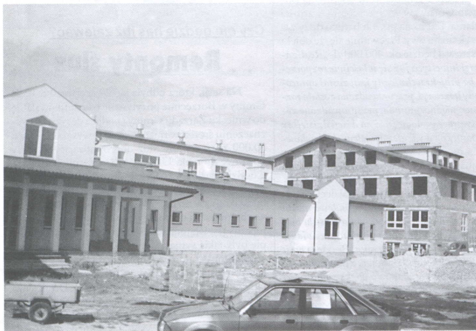
Rozpisano przetarg na plac przed halą – na dzień dzisiejszy kładziona jest kostka brukowa, do dnia otwarcia teren będzie już uporządkowany.
