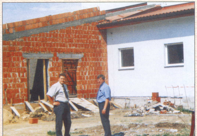
Wójt Kwaśniak i wice-wójt Małek twierdzą: „Kotłownia będzie na 1 września br.” Wierzymy...
